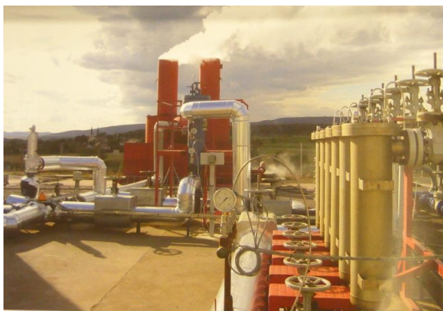
Figure 24. La centrale géothermique de Soultz-sous-Forêts, dans le département du Bas-Rhin (BRGM Im@gé).
