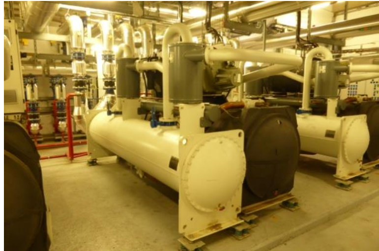
Figure 17. Pompes à chaleur de la centrale géothermique de la Maison de la Radio (photo F. Audubert).
